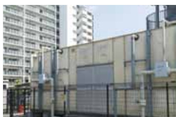
●タンク内の残量監視
