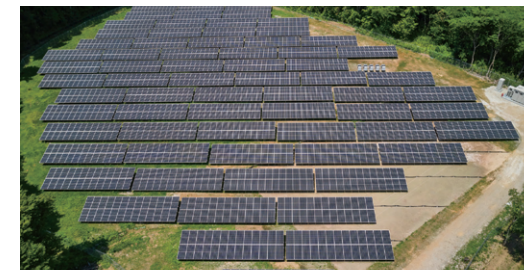
千葉県千葉市 出力:約0.8MW (PPA)
